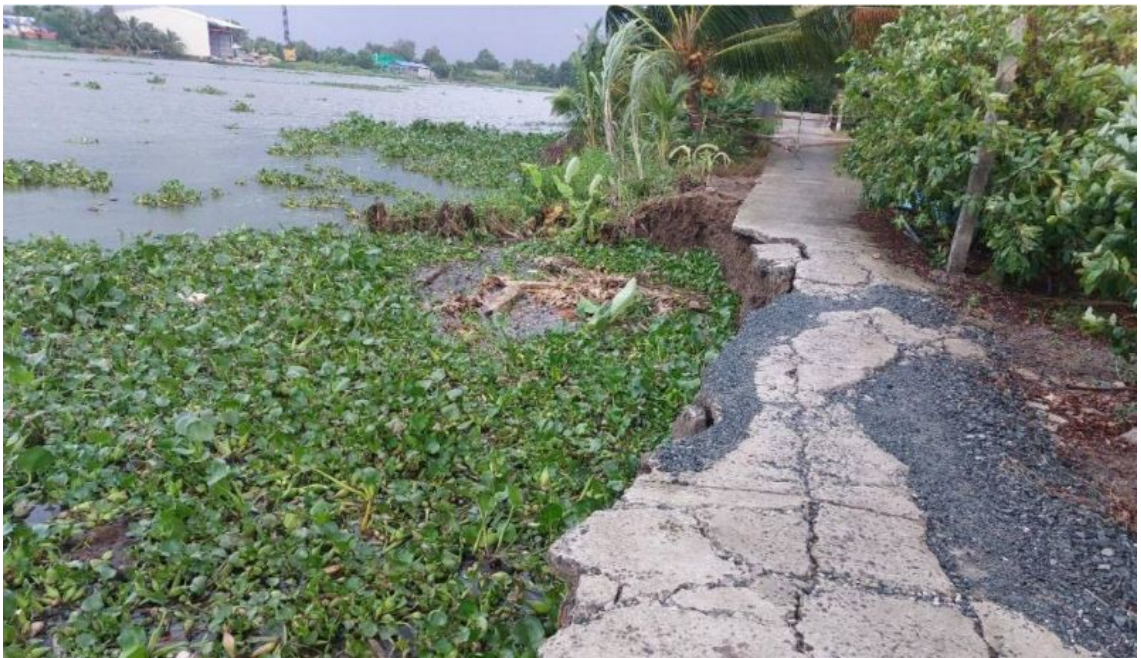
Đảm bảo công tác phòng, chống sạt lở bờ sông, kênh, rạch
