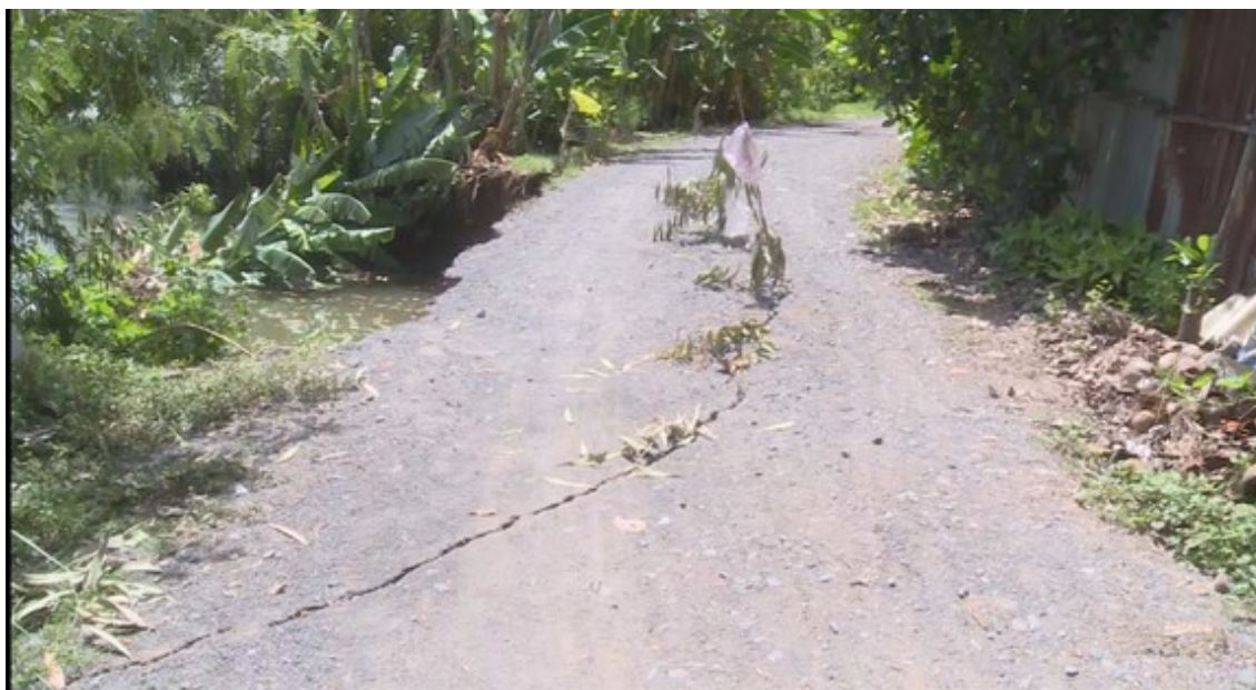
Tuyến đường đê bị rạn nứt (Ảnh: Bắc Bình)
