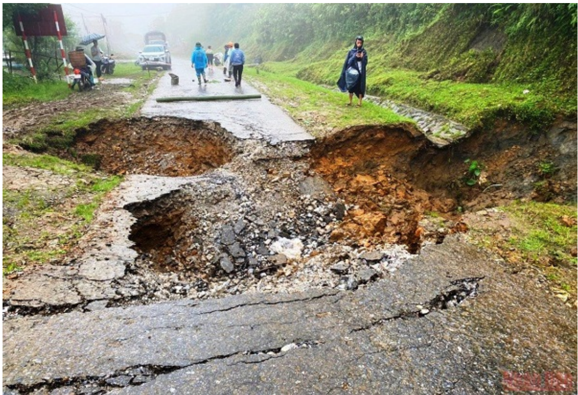
Sạt lở gây ách tắc giao thông trên tỉnh lộ 155 ở thị xã Sa Pa, tỉnh Lào Cai.
