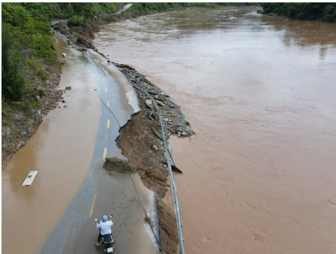
Mưa lũ gây ảnh hưởng nghiêm trọng tại tỉnh Nghệ An, khiến nhiều địa phương bị chia cắt, hư hỏng nặng hạ tầng
