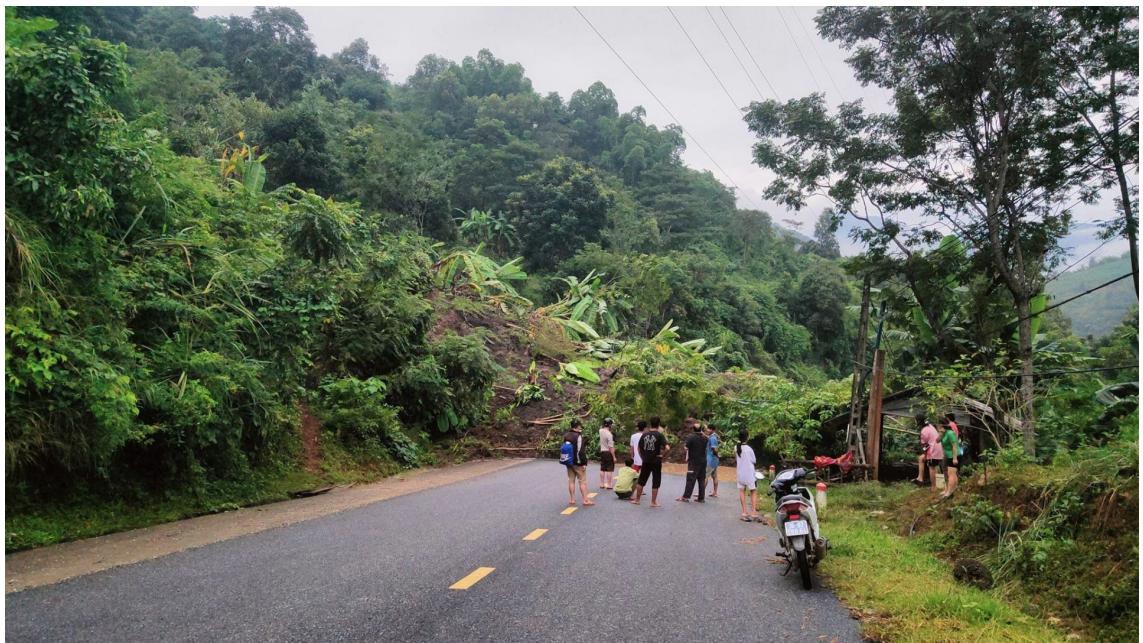
Điểm sạt lở trên tuyến QL15C gần cổng Trường PTDT BÁN TRÚ THCS Pù Nhi, huyện Mường Lát, tỉnh Thanh Hóa
