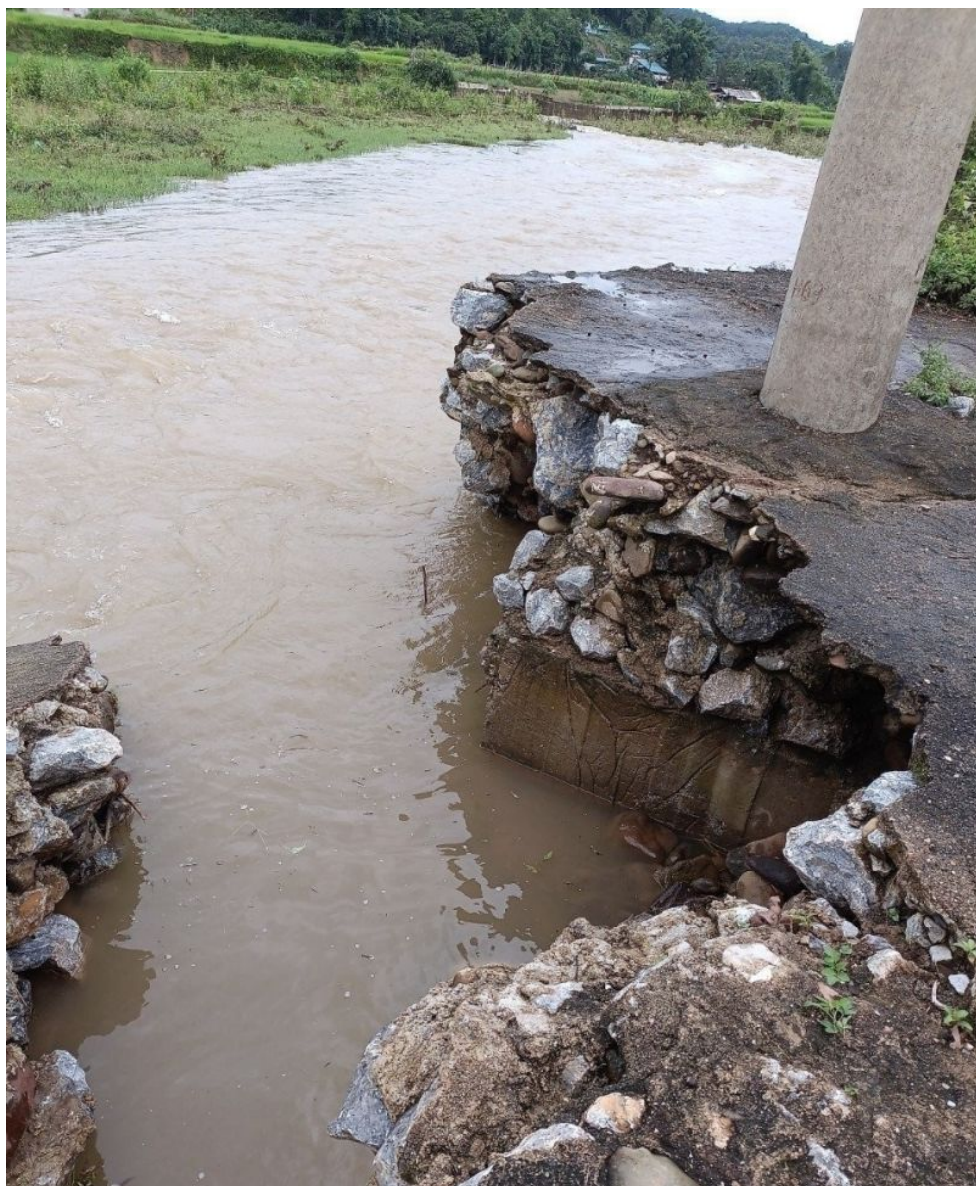
Móng cột điện tại Lai Châu bị sạt lở
