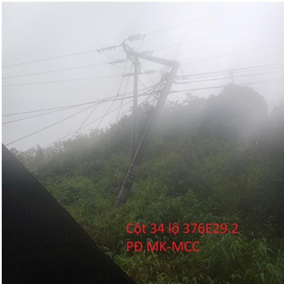
Cột điện tại Yên Bái bị nghiêng do sạt lở đất
