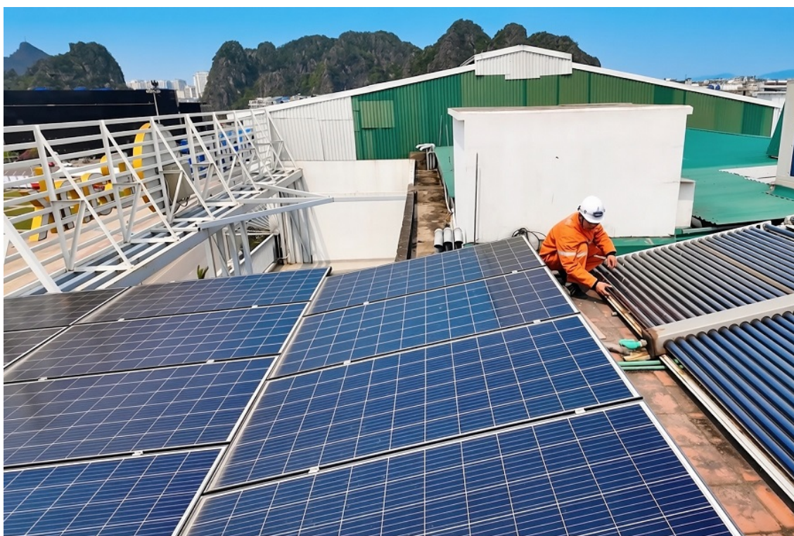
Điện mặt trời mái nhà tại Quảng Ninh
