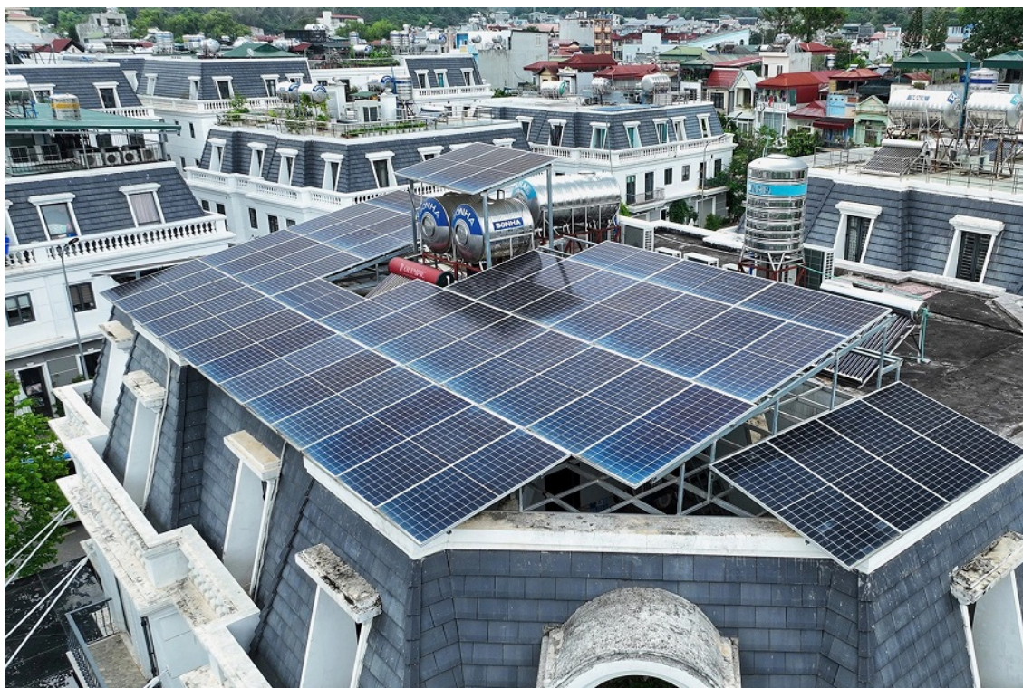
Điện mặt trời được lắp trên mái nhà dân tại Sơn La
