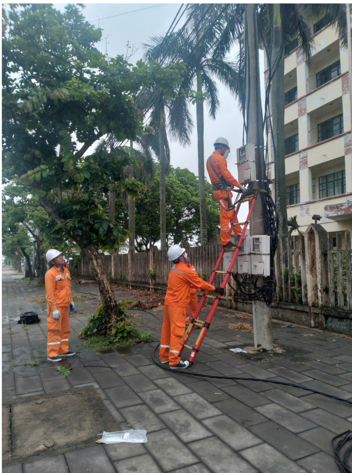
Đảm bảo cấp điện ổn định, an toàn trong mùa nắng nóng
