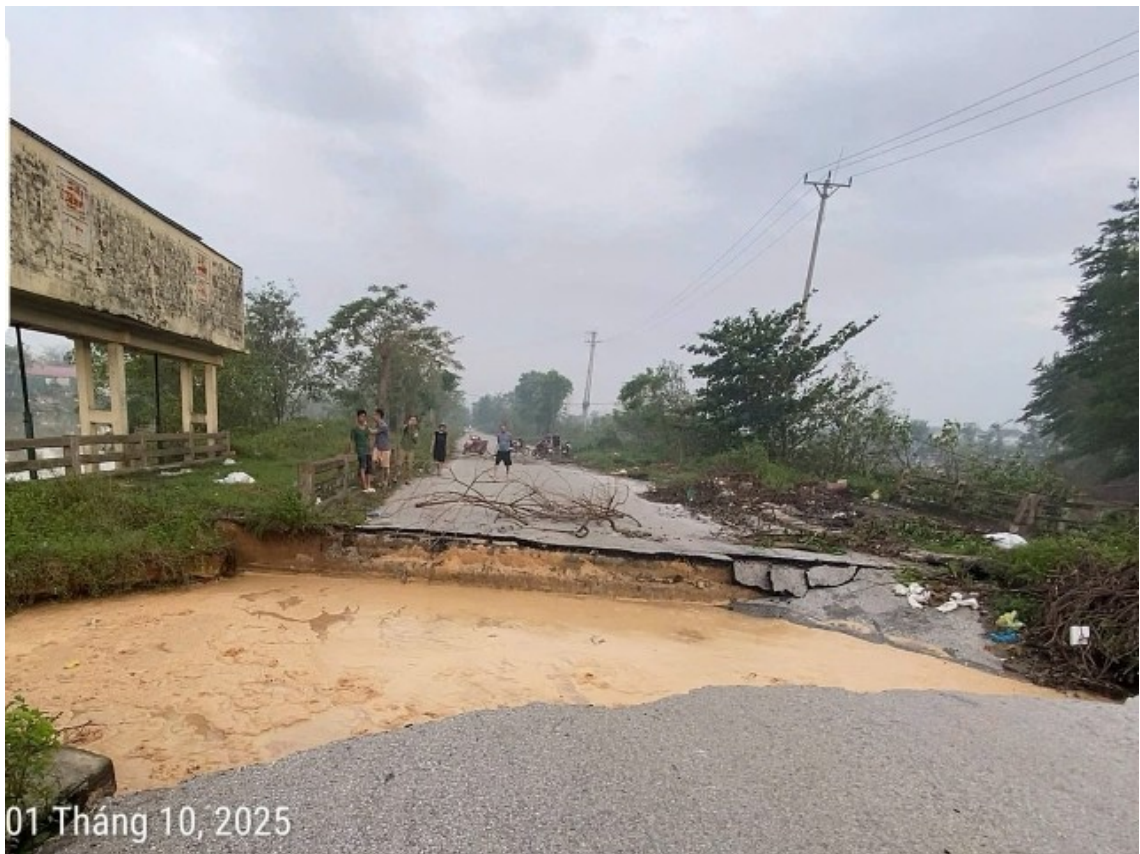
Đoạn bờ sông Vinh bị vỡ
