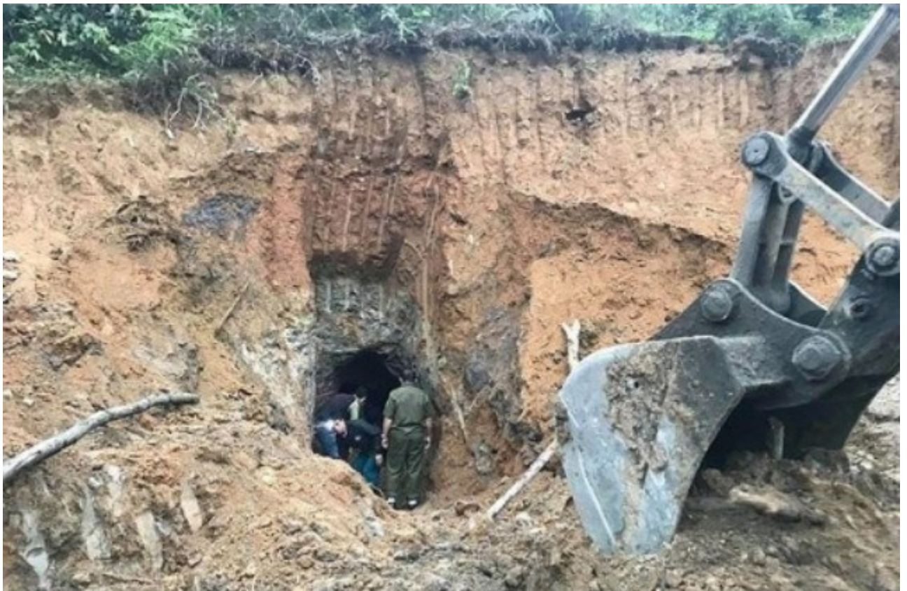
Hiện trường vụ sập hầm thiếc khiến 3 người tử vong
