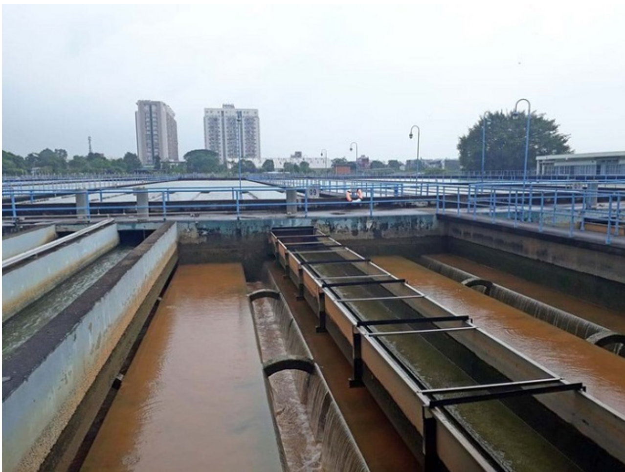
Bể lắng lọc nước ngoài trời của Nhà máy nước Thủ Đức
