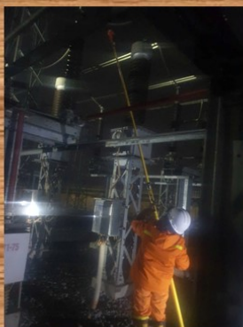
Thao tác thử hết điện bằng bút thử điện trước khi đóng tiếp địa
