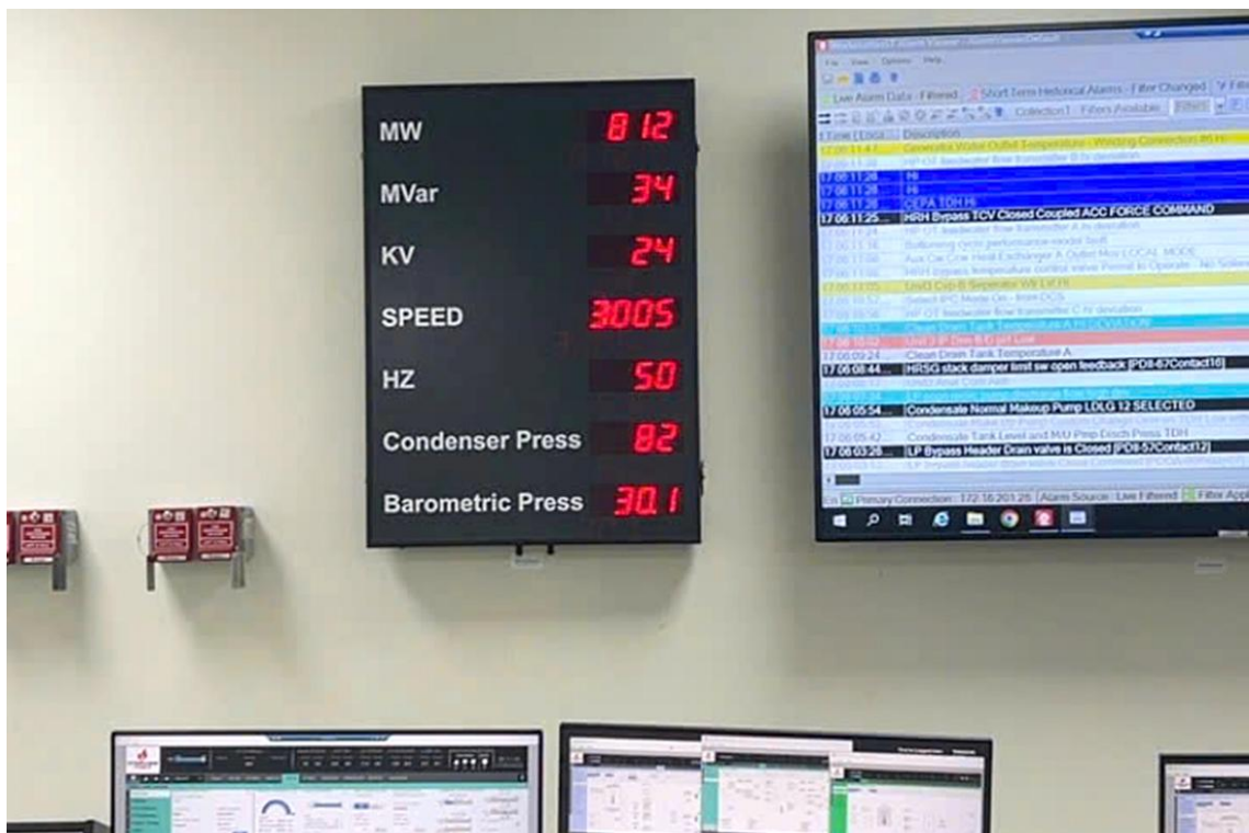
Hình ảnh Nhà máy điện Nhơn Trạch 3 đạt công suất tối đa 812MW
