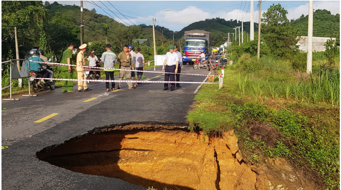
Sạt lở ăn sâu vào gần một nửa mặt đường Tỉnh lộ 721 đoạn qua xã Đa Lây (Ảnh: Báo Lâm Đồng)
