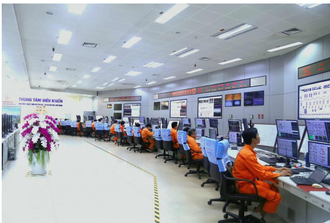
Trung tâm Điều khiển Nhà máy Nhiệt điện Duyên Hải
