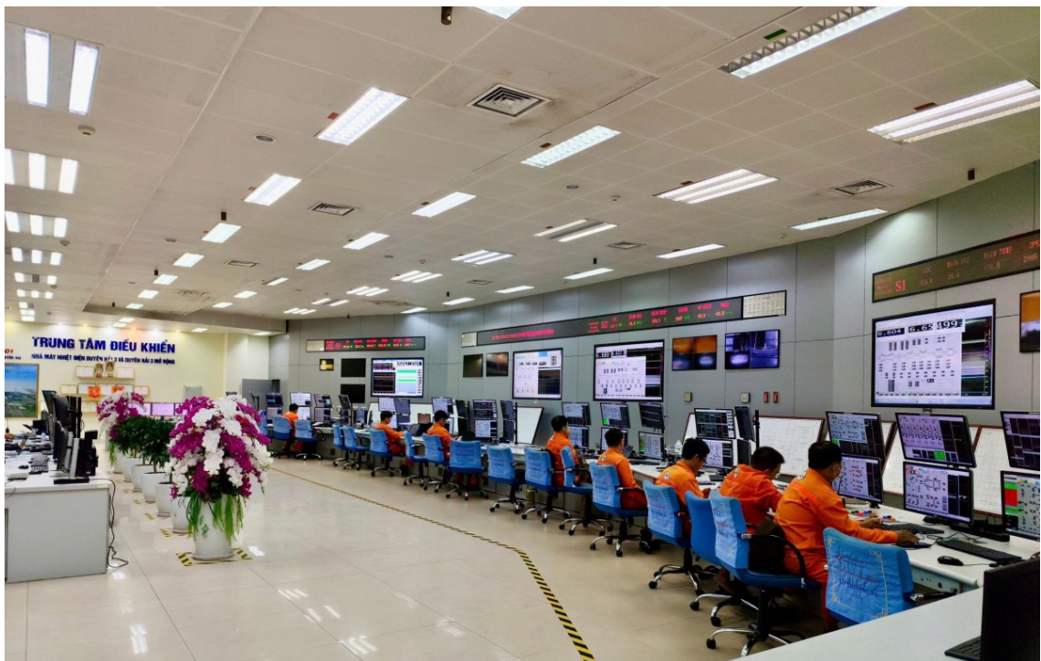
Trung tâm điều khiển Nhà máy Nhiệt điện Duyên Hải 3
