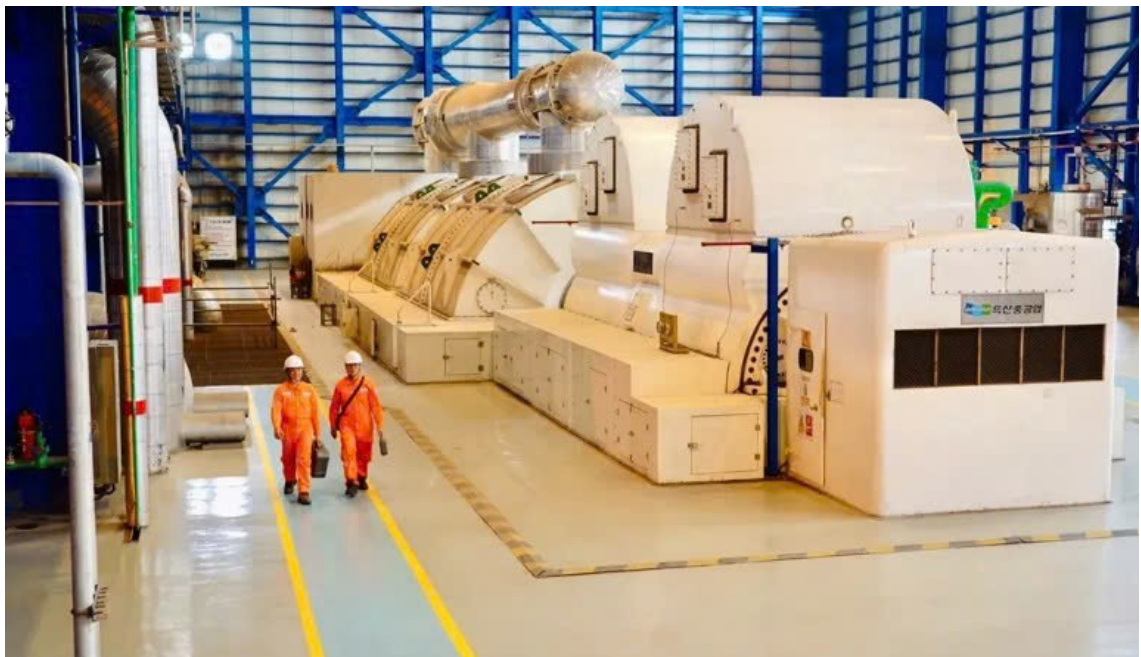
Khu vực tua bin tổ máy số 1 Nhà máy Nhiệt điện Mông Dương
