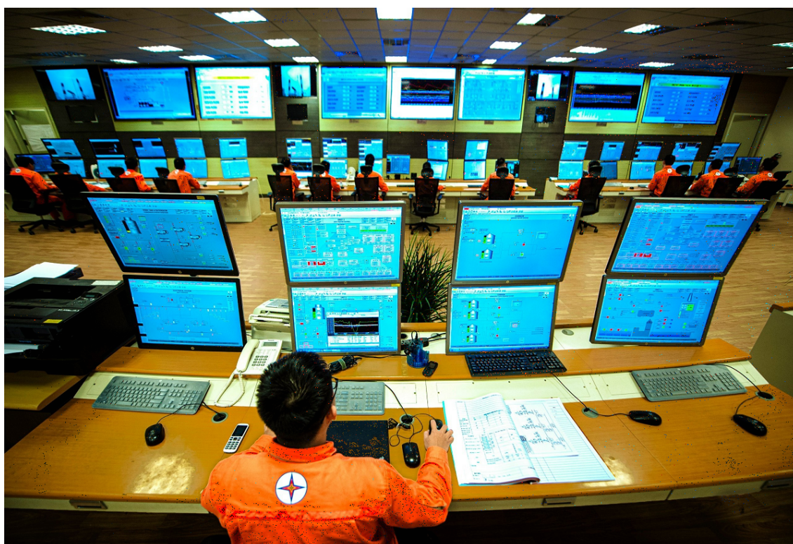
Cán bộ, công nhân viên làm việc tại phòng điều khiển trung tâm của Nhà máy Nhiệt điện Vĩnh Tân 4
