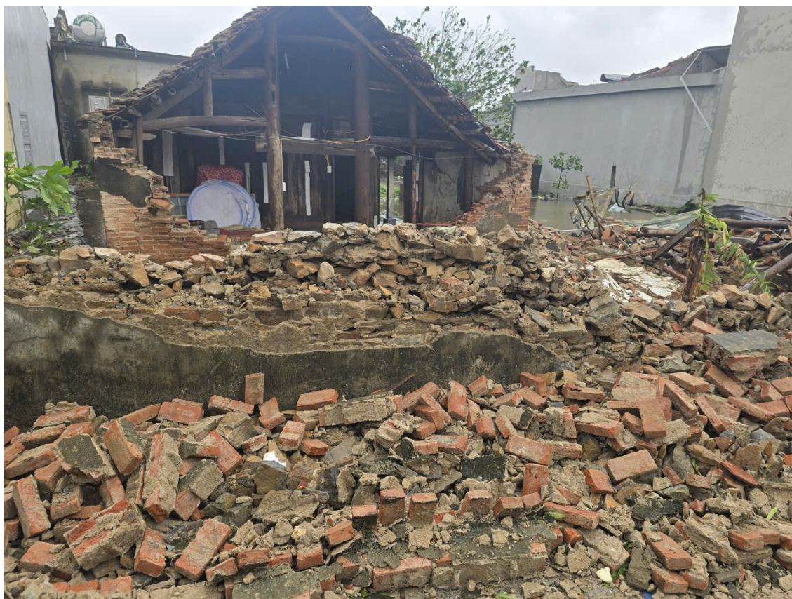
Ngôi nhà trên địa bàn xã Hoàng Phú bị đổ sập, hư hại hoàn toàn
