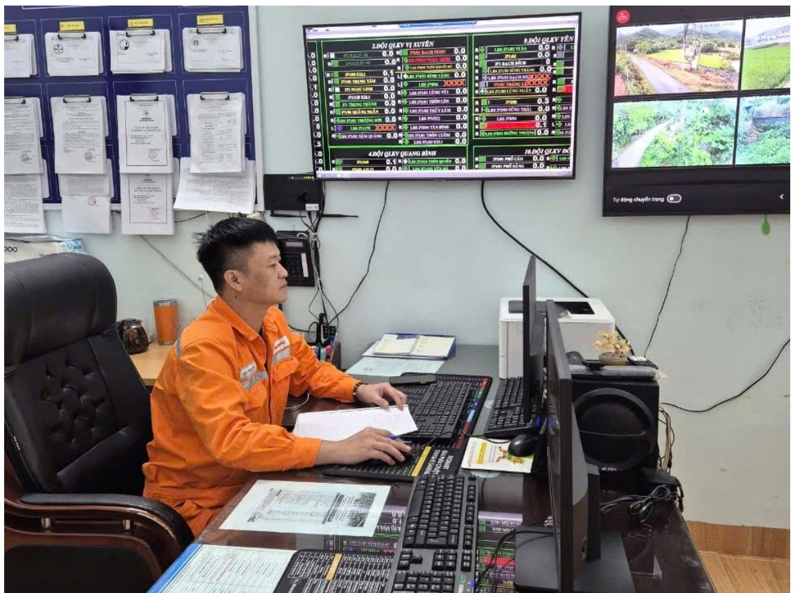
Anh Đỗ Trung Kiên, nhân viên Tổ trực vận hành Điện lực Vị Xuyên, Công ty Điện lực Tuyên Quang thực hiện nhiệm vụ trực vận hành trong dịp Quốc khánh 2/9
