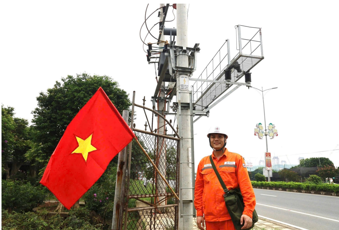
Kỹ sư Lê Đức Cường, Điện lực Văn Giang, Công ty Điện lực Hưng Yên kiểm tra thiết bị bằng camera ảnh nhiệt tại Trạm biến áp Như Phượng 1
