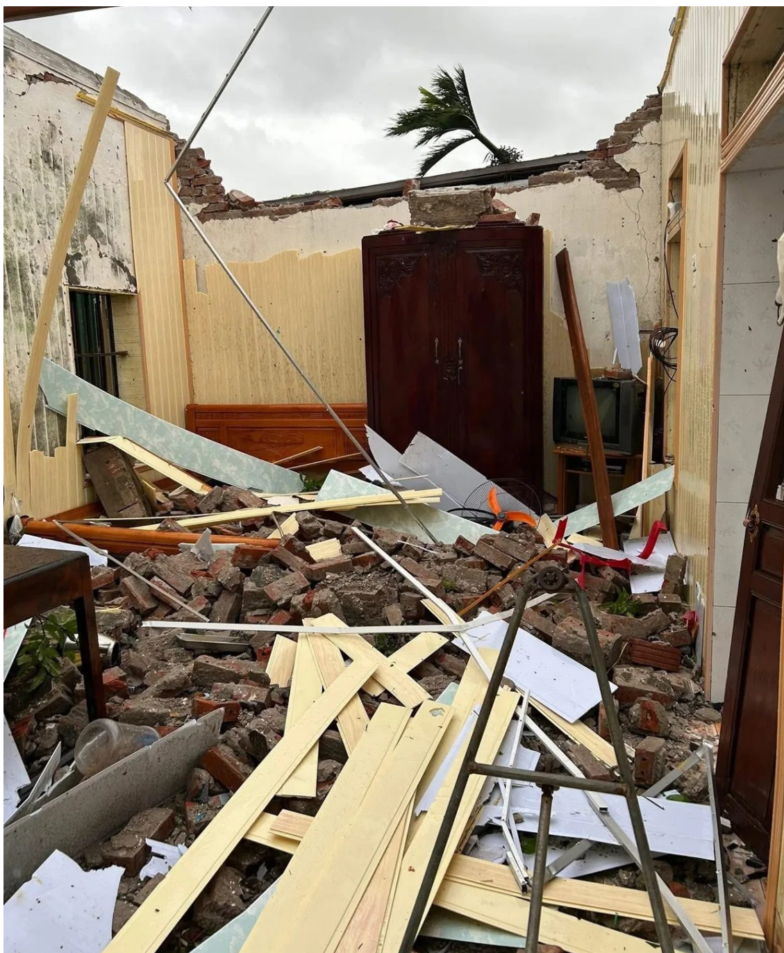
Thiệt hại về nhà ở cũng rất lớn với 11 nhà cấp 4 bị đổ sập và 126 nhà bị hư hỏng, tốc mái
