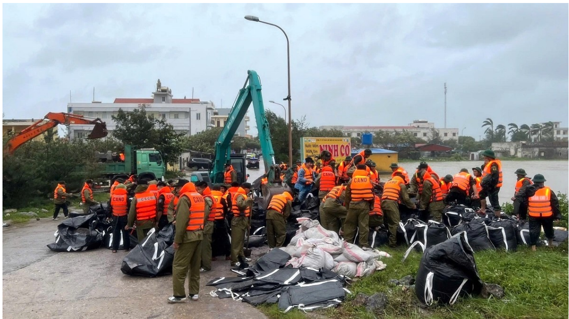
Lực lượng chức năng Ninh Bình khắc phục sự cố đoạn kè biển Hải Thịnh 3
