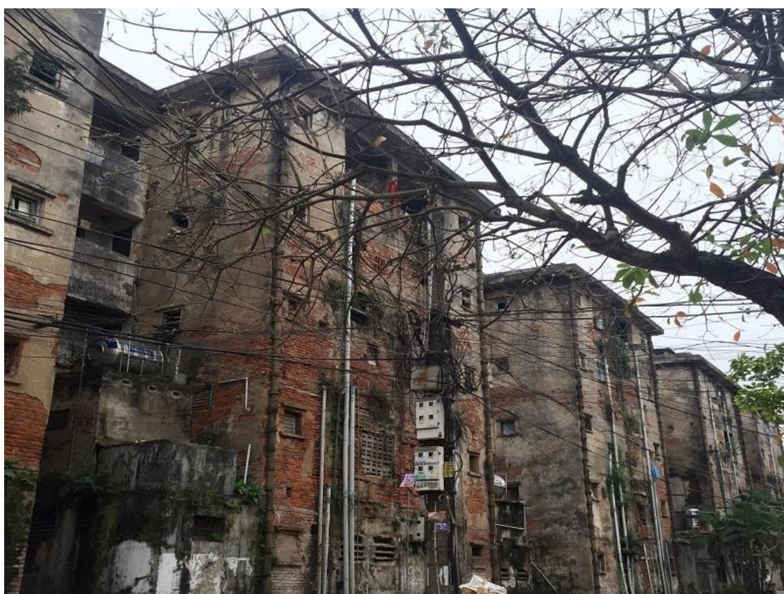
Khu tập thể 5 tầng (hay còn gọi toà nhà chợ 5 tầng, phường Trần Đăng Ninh, TP Nam Định cũ) được xây dựng từ năm 1978, nay đã xuống cấp
