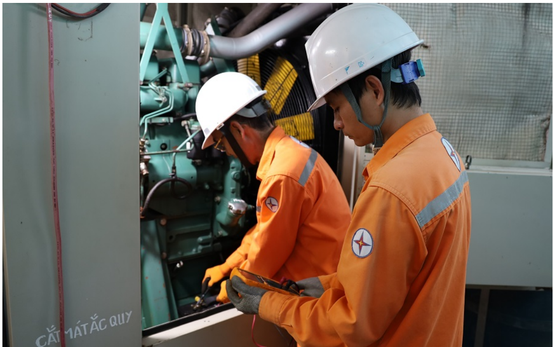
Công nhân Đội QLĐLKV Điện Biên Phủ kiểm tra máy phát điện dự phòng
