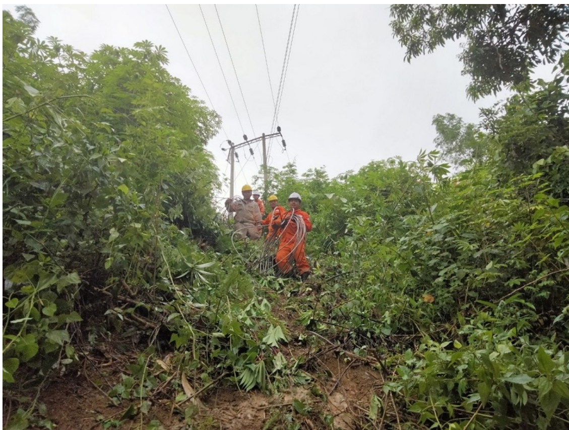
Công nhân Điện lực Mường Chà - PC Điện Biên khắc phục sự cố đứt dây, gãy xà do sạt taluy cây đổ vào đường dây
