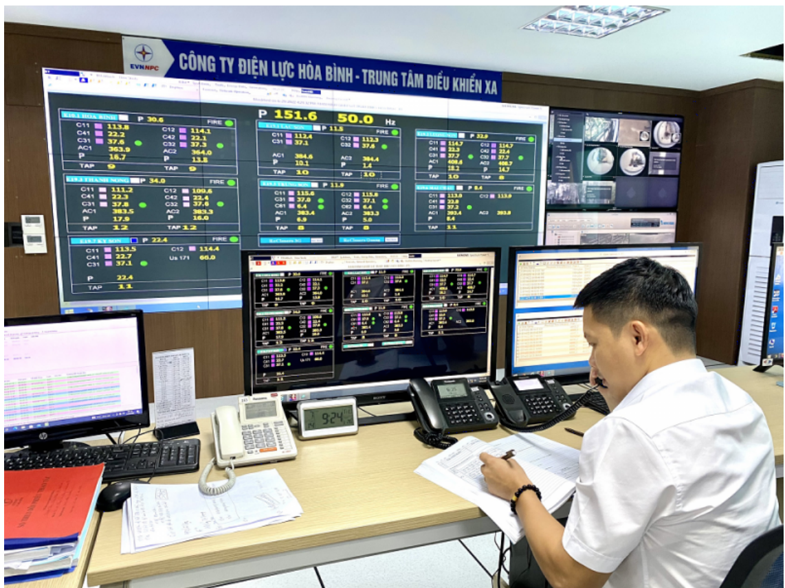
Trung tâm Điều khiển xa PC Hòa Bình- Bộ não của hệ thống lưới điện.
