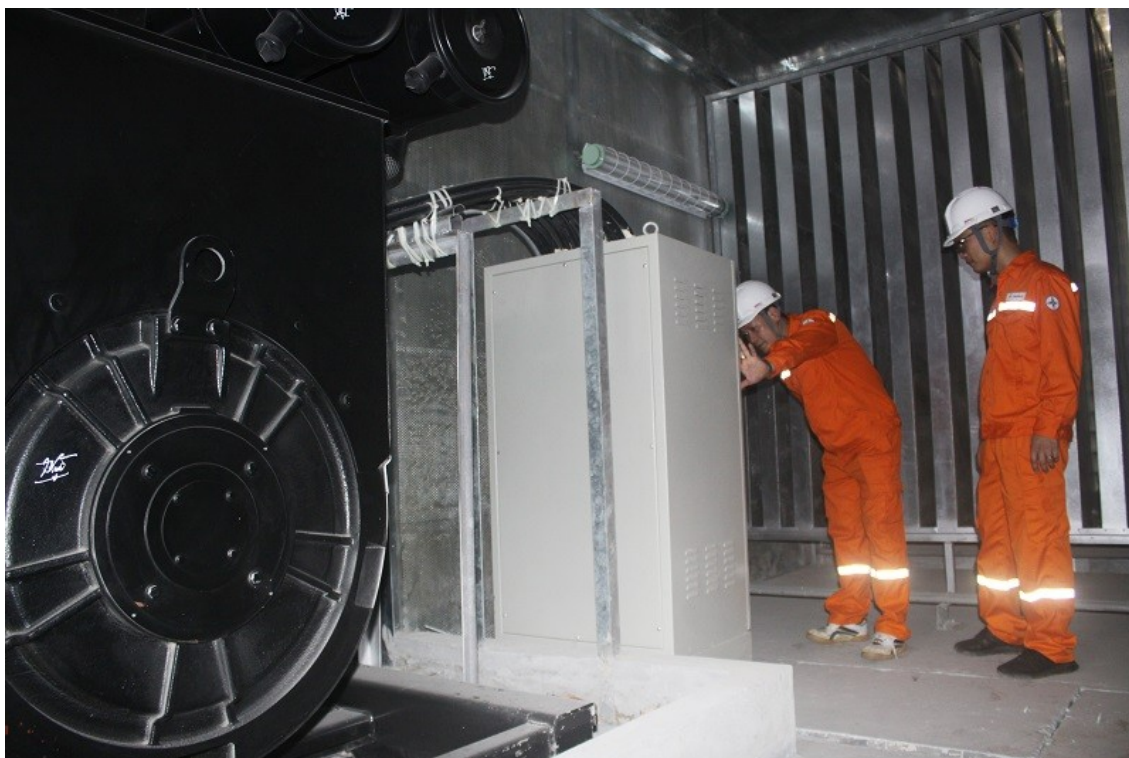
Công nhân Điện lực Kim Bôi kiểm tra máy biến áp của khách hàng
