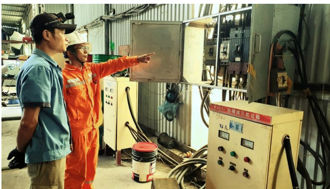
Công nhân điện lực Hòa Bình hướng dẫn ông Hoàng Văn Khả sử dụng thiết bị máy móc sao cho hiệu quả, tiết kiệm điện
