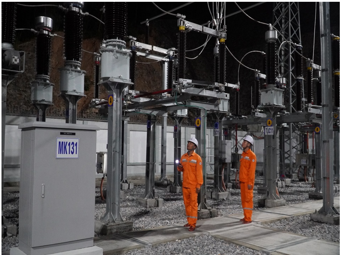
Tổ thao tác lưu động kiểm tra thông số kỹ thuật giờ cao điểm tại TBA 110 kV Yên Cư (TBA 110 kV thứ 21 của PC Quảng Ninh)
