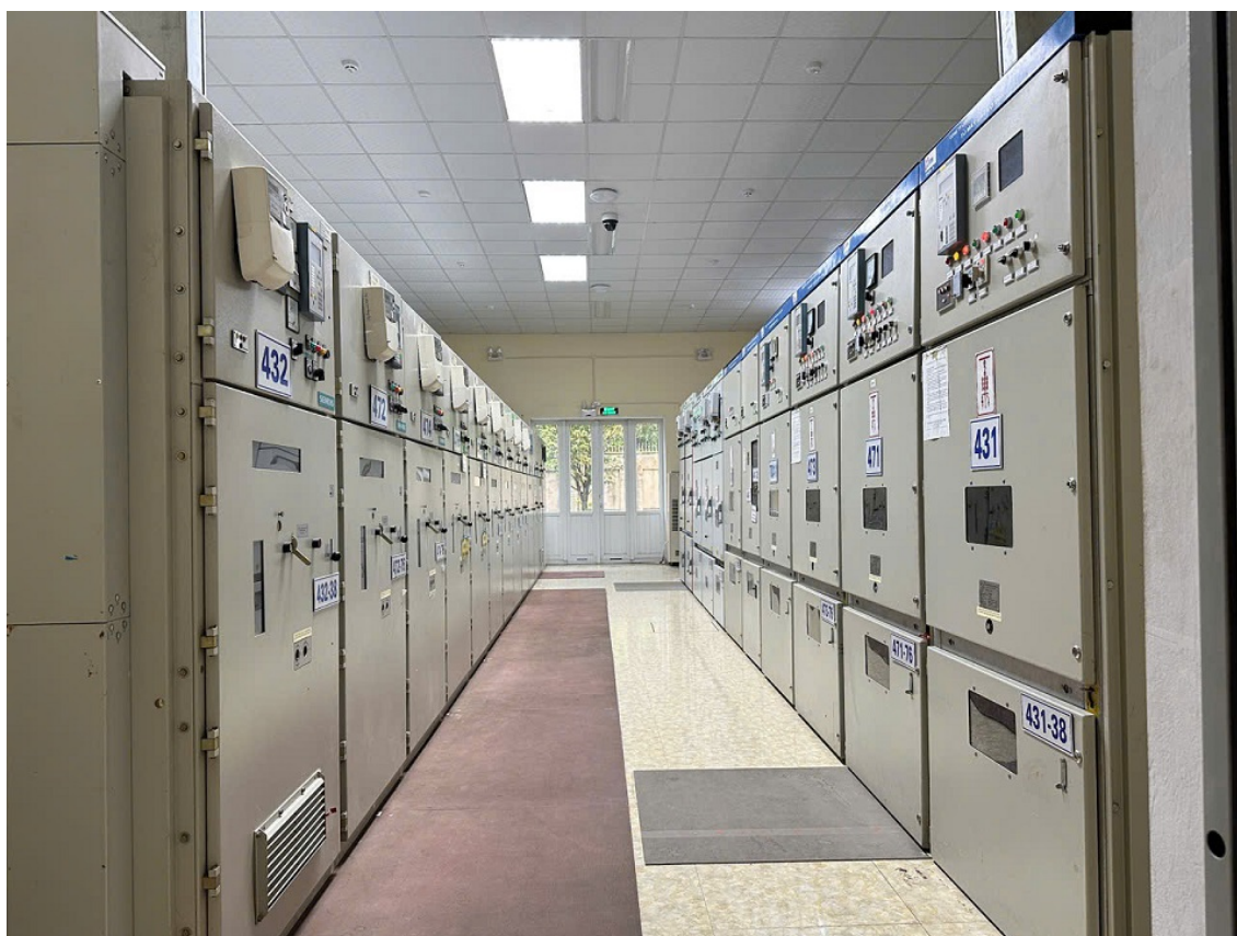
21 TBA 110 kV không người trực...
