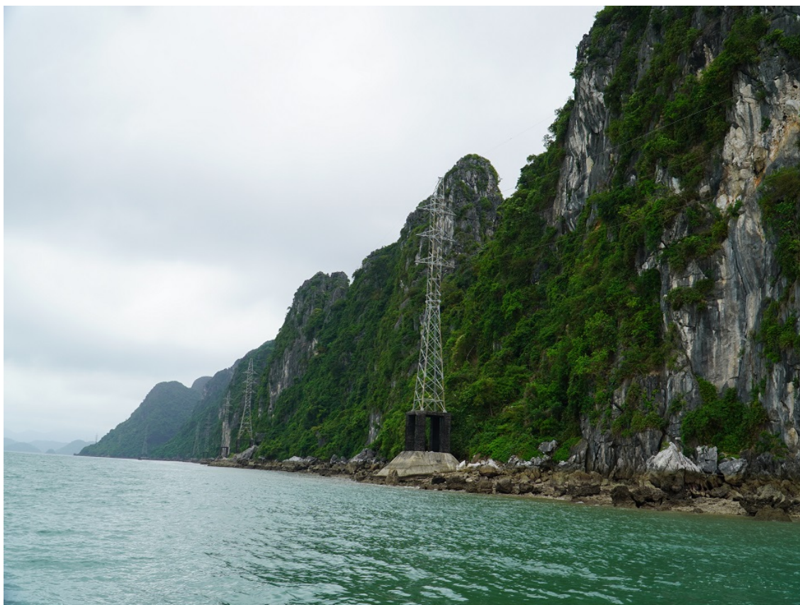
Đường dây 22 kV trên không vượt các đảo đưa điện ra đảo Cô Tô
