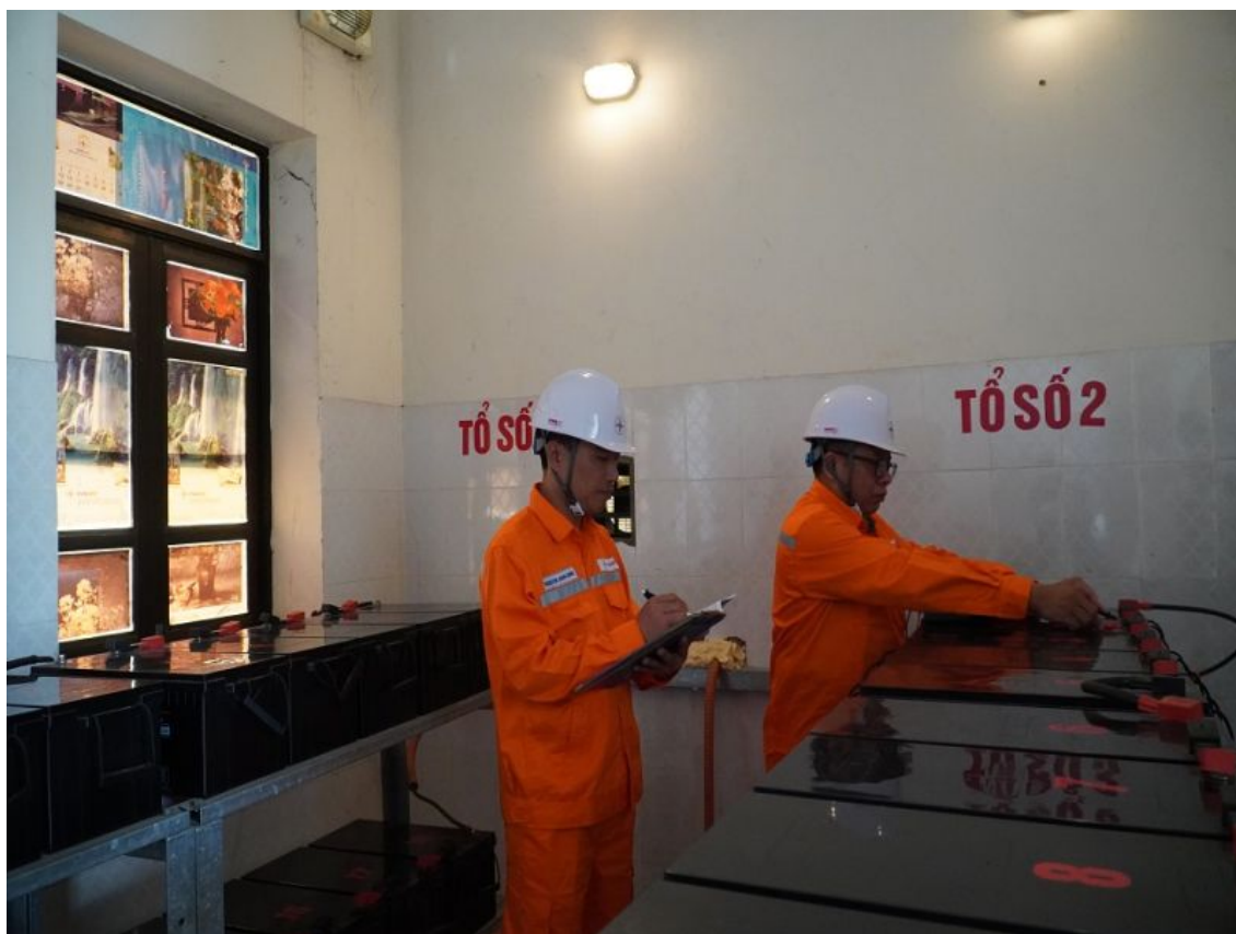
Kiểm tra thiết bị điện 1 chiều cấp nguồn bảo vệ điều khiển TBA 110 kV Cái Lân
