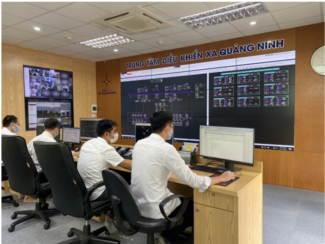
Trung tâm Điều khiển xa, thực hiện chức năng điều độ vận hành lưới điện cấp điện áp đến 110kV trên toàn tỉnh Quảng Ninh.
