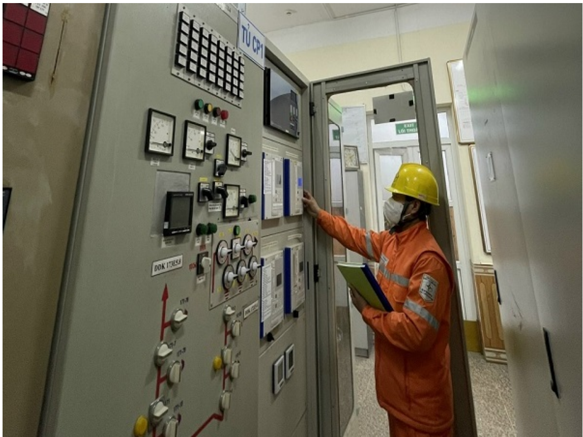
Công nhân TBA 110 kV Cái Lân kiểm tra thông số vận hành giờ cao điểm.
