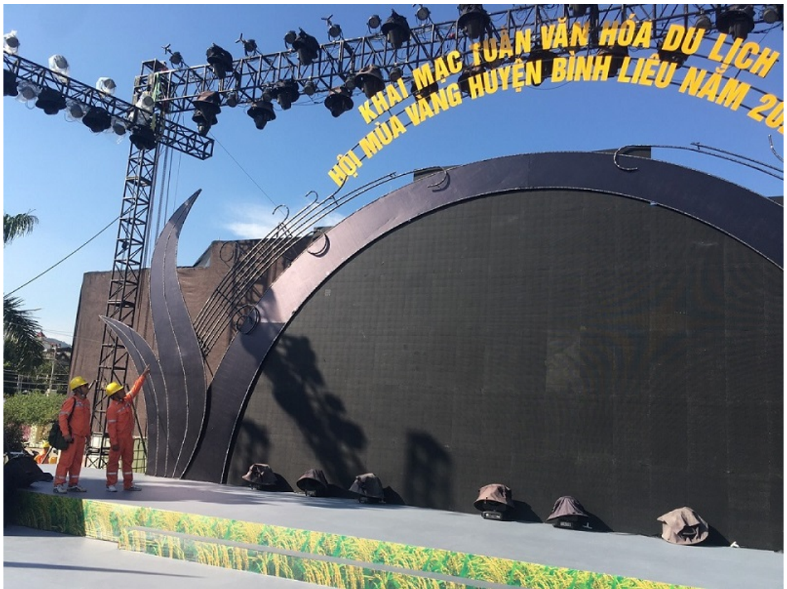
Kiểm tra hệ thống điện đảm bảo cung cấp điện cho lễ hội.
