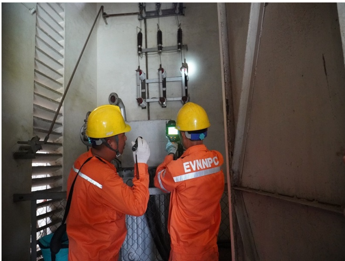
Công nhân Điện lực TP Hạ Long kiểm tra nhiệt độ thiết bị điện giờ cao điểm.
