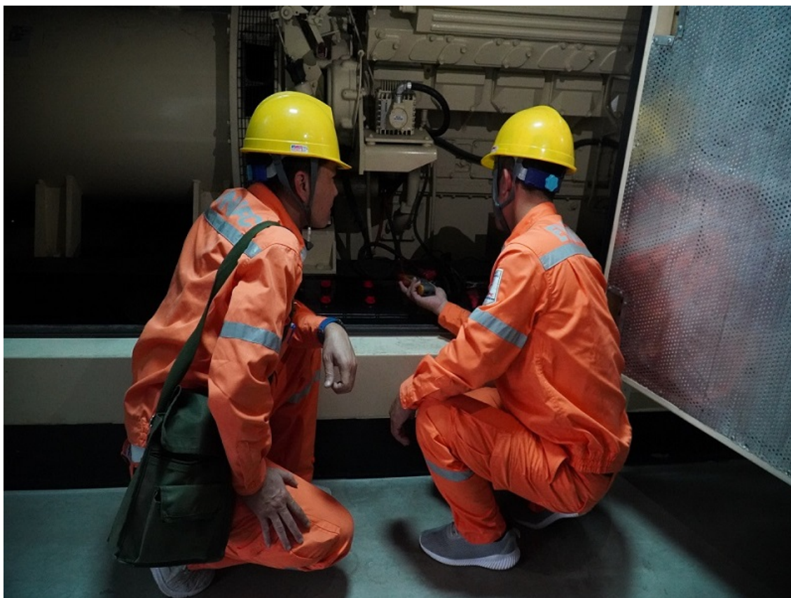
Kiểm tra thông số kỹ thuật máy biến áp.
