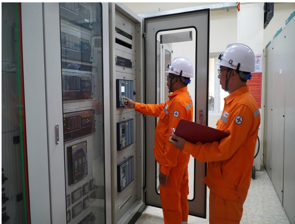
Tổ thao tác lưu động kiểm tra thông số kỹ thuật tại TBA 110 kV Cái Lân
