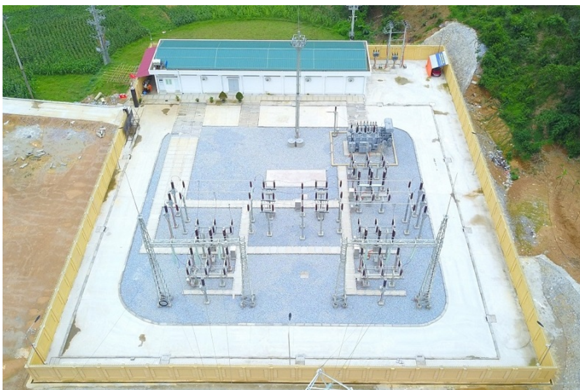
Toàn cảnh Trạm biến áp 110kV Na Hang áp dụng vận hành lưới điện không người trực
