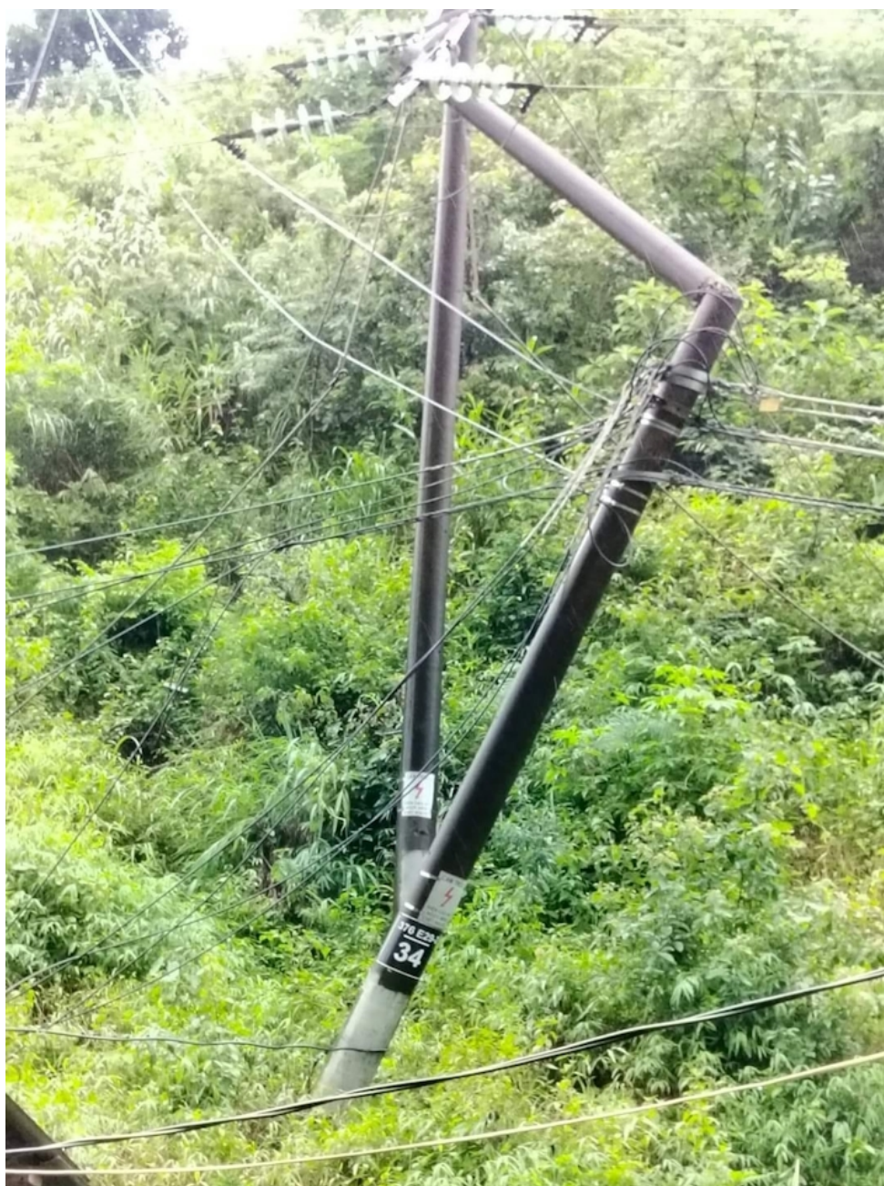
Cột điện thuộc đường dây 35kV lộ 376E29.2 phân đoạn Mường Kim - Mù Cang Chải bị gãy, đổ
