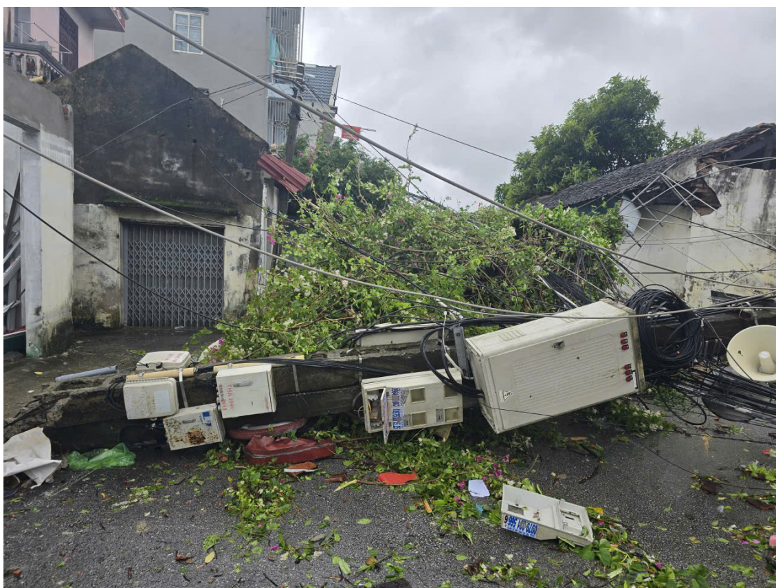
Mưa lớn, gió giật mạnh làm gãy, đổ cột điện.
