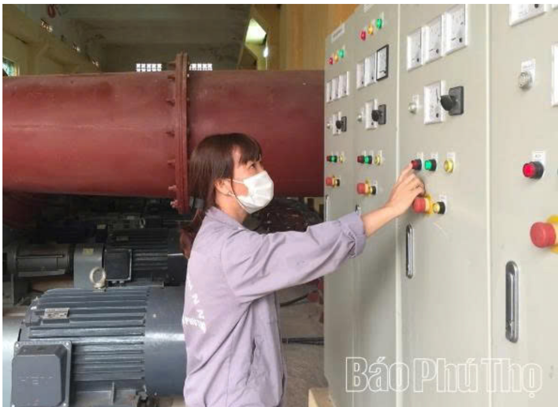
Công nhân Trạm bơm Tân Xuôi vận hành hệ thống máy bơm tiêu thoát nước. (Ảnh: Báo Phú Thọ)
