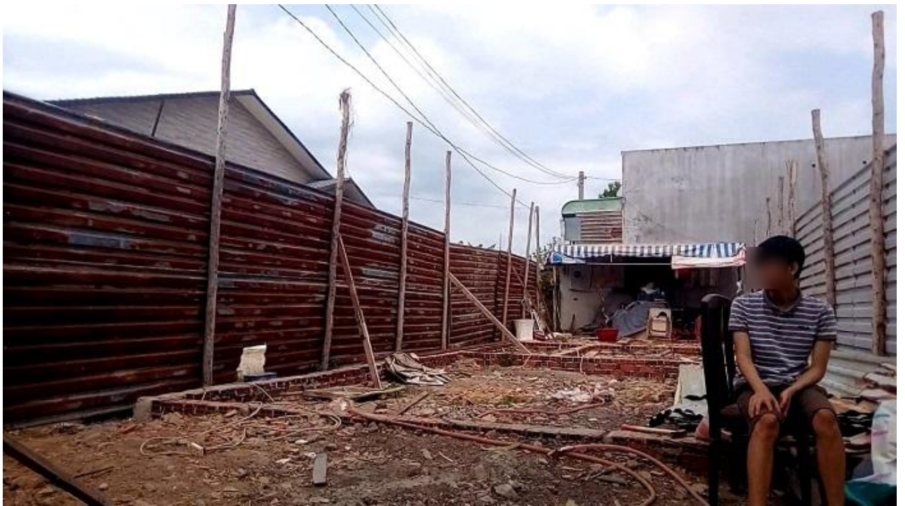
Một công trình xây dựng trái phép trên đất nông nghiệp đang trong giai đoạn hoàn thiện móng tại hẻm 442 Bình Giã. (Ảnh: Vũ Bảo)
