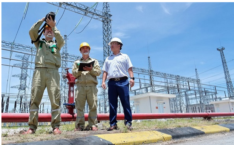
Ông Phạm Quang Hòa – Phó Giám đốc PTC1 kiểm tra công tác vận hành trạm biến áp
