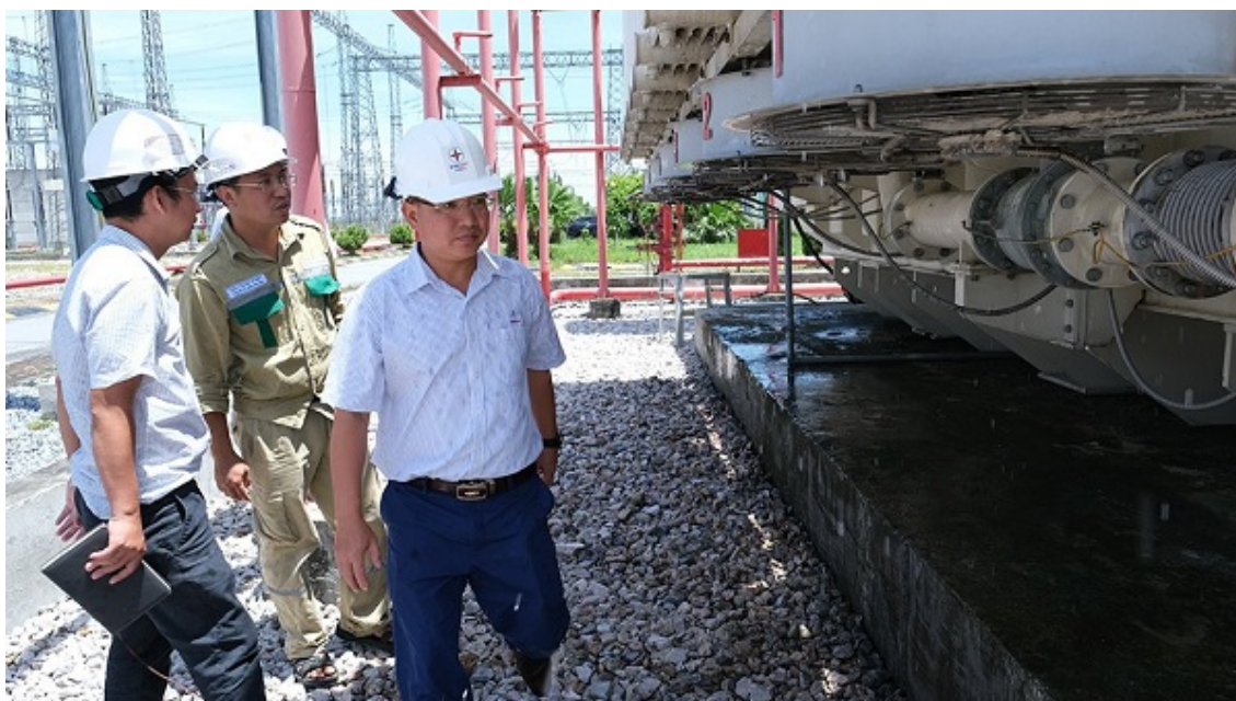
Ông Phạm Quang Hòa - Phó giám đốc PTC1 kiểm tra hệ thống làm mát máy biến AT3 tại TBA 500kV Tây Hà Nội, tháng 06/2022
