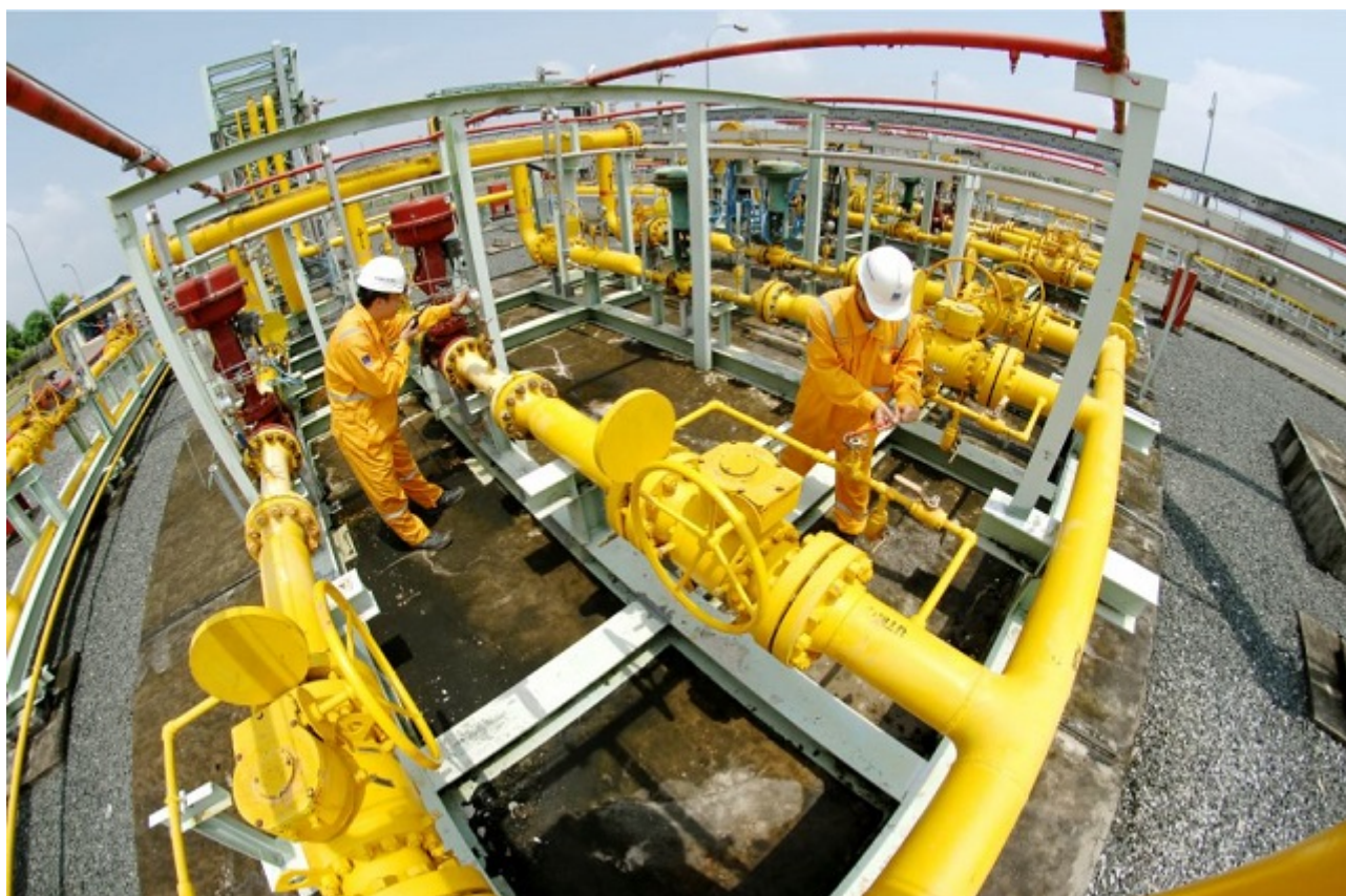
Các công trình khí được PV GAS sử dụng an toàn – hiệu quả (Ảnh: Lê Vũ - Bảo Trần)
