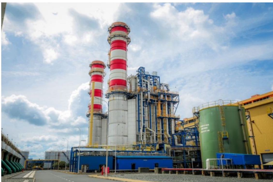
Tổng công ty Điện lực Dầu khí Việt Nam - PV Power
