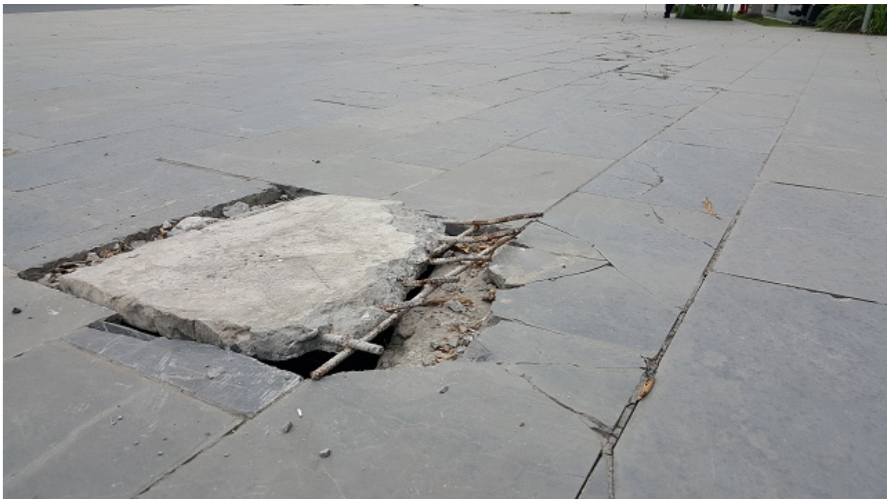
Miếng cống mất nắp được che tạm sài bằng khối bê tông
