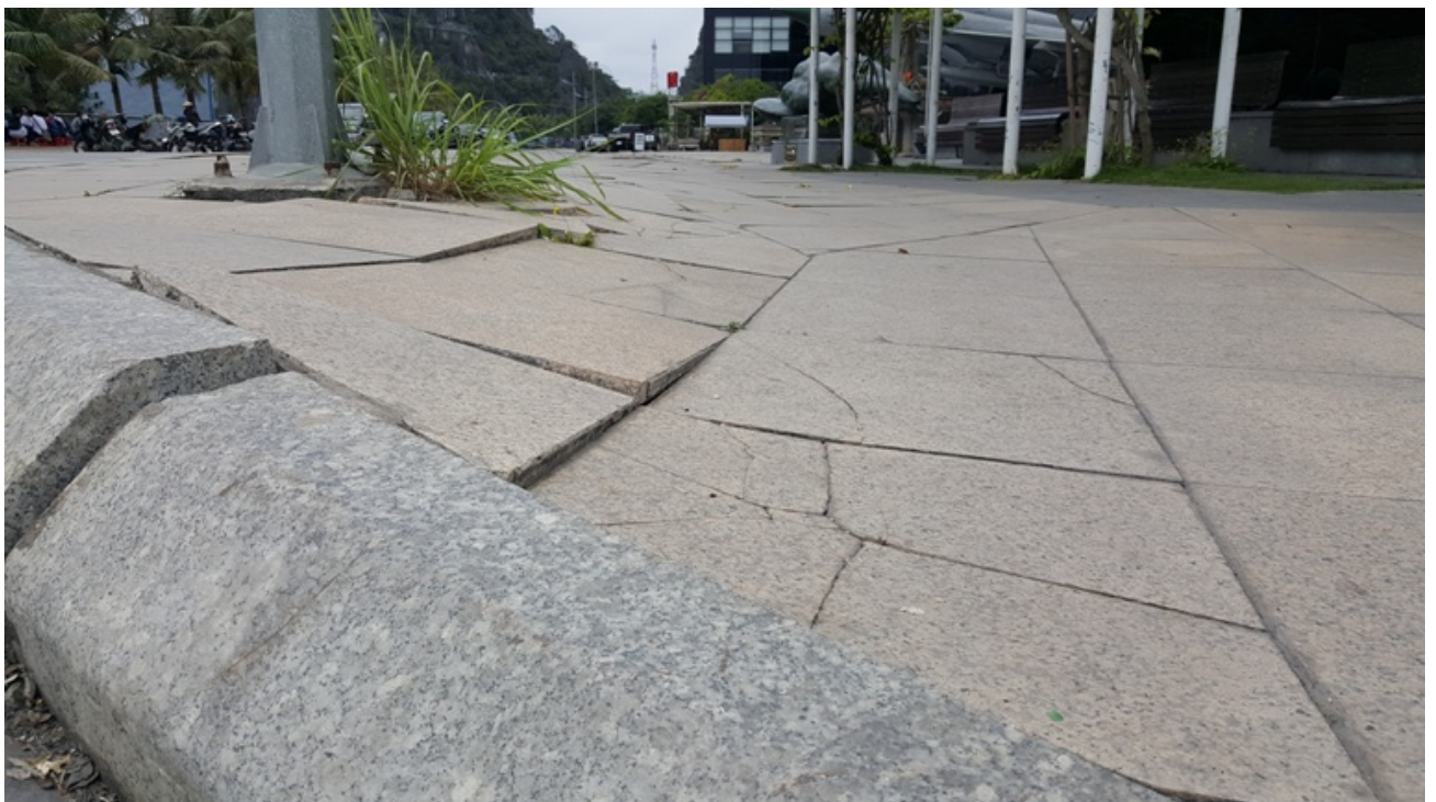
Rất nhiều nơi trên mặt nền công trình gặp tình trạng sụt lún
