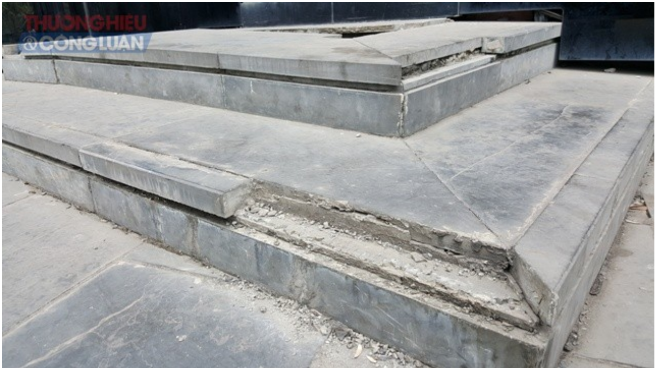
Bậc thềm tại công trình thư viện - bảo tàng nứt vỡ, lộ cả kết cấu sắt thép do chất lượng thi công kém.
