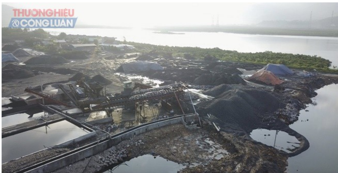
Hệ thống sàng tuyển, lọc rửa than tại bến cảng
