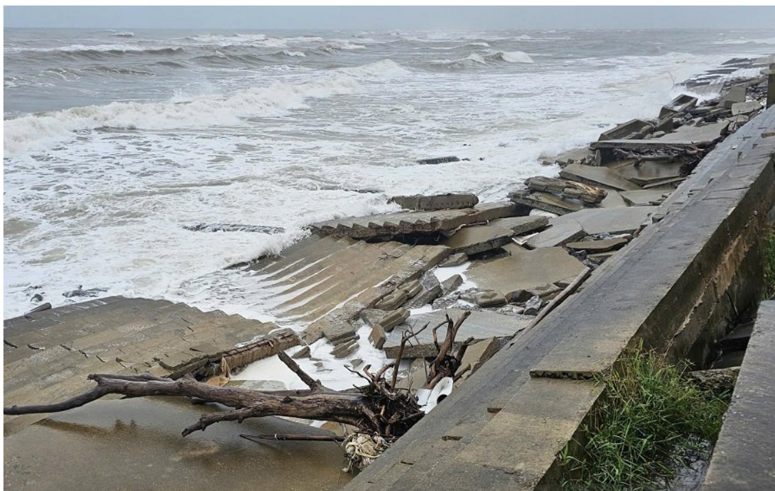
Kè bờ biển Nhật Lệ bị sóng lớn đánh gãy sập. (Ảnh: PK)
