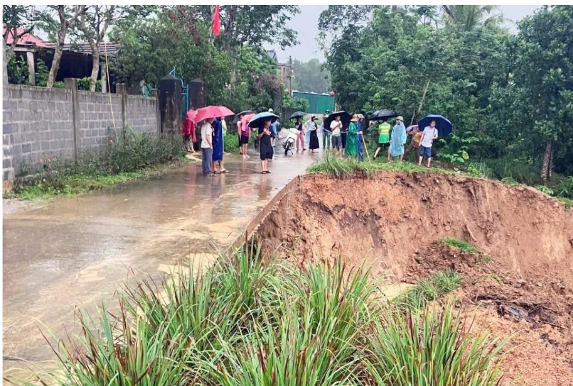
Sạt lở sạt đường giao thông tiềm ẩn nguy cơ mất an toàn
