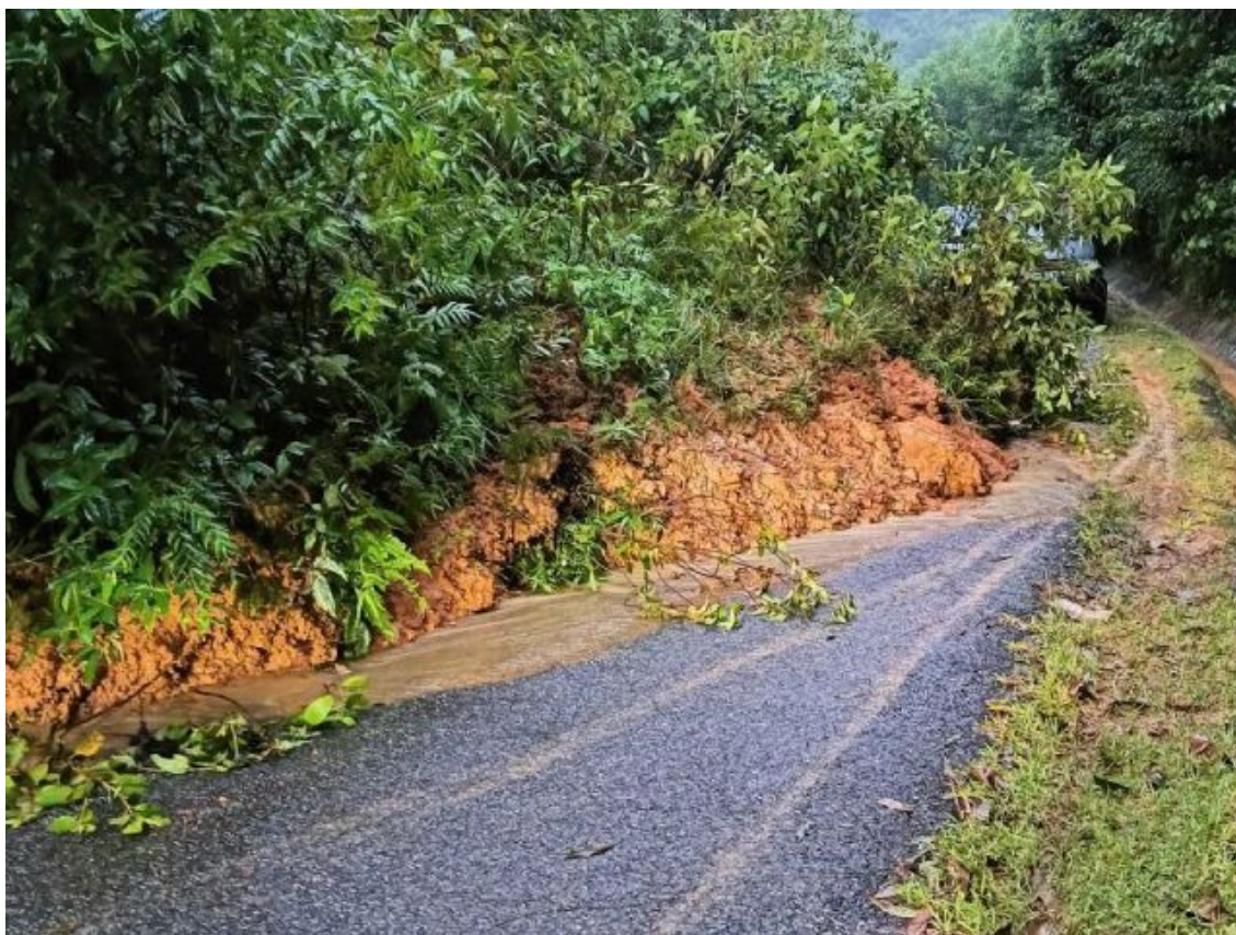
Hiện toàn vẫn còn 33 điểm sạt lở.
