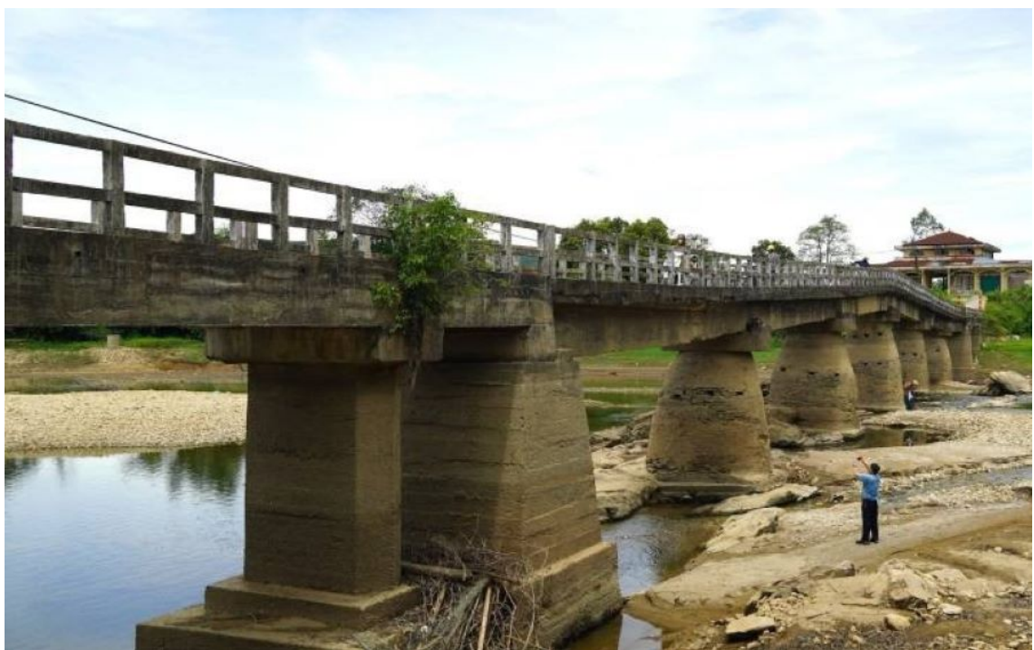
Quảng Trị rà soát, kiểm tra tất cả các cầu yếu, xuống cấp trên địa bàn.
