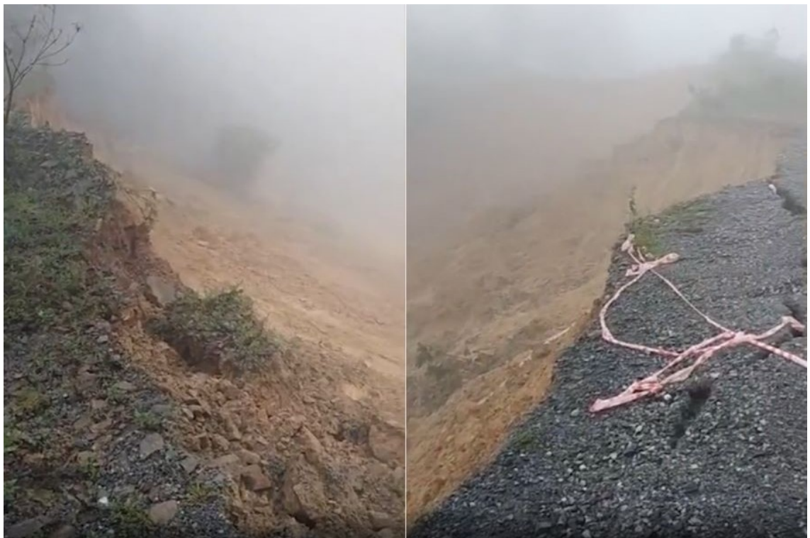
Xuất hiện nhiều điểm sạt lở trên tuyến đường Hồ Chí Minh nhánh Tây.
