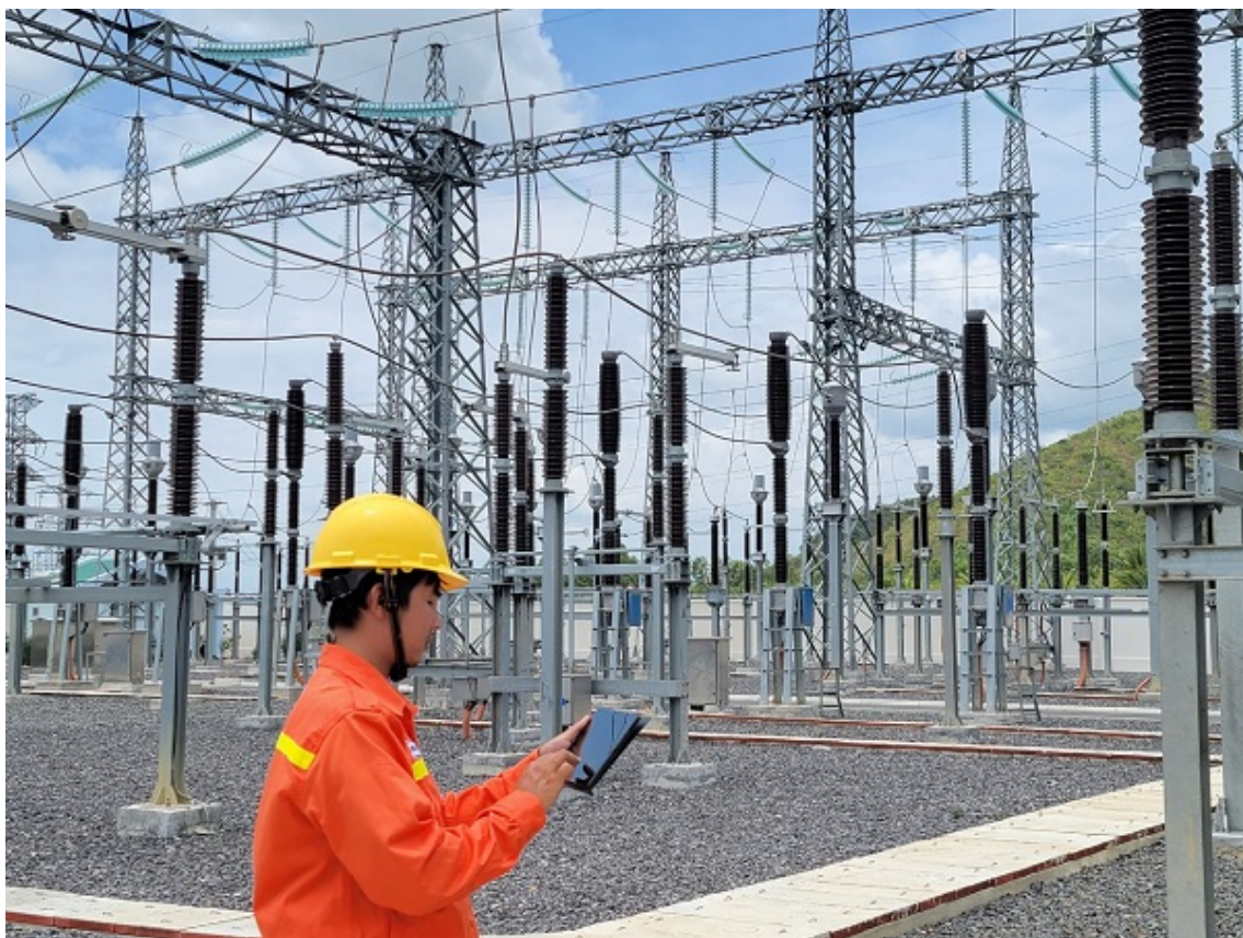
Sử dụng Ipad kiểm tra thông số thiết bị Trạm biến áp 220kV Vân Phong
